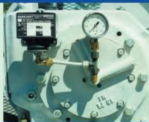
Sistema de lubrificação forçada com pressostato
