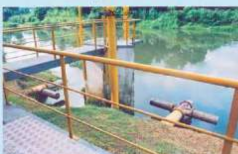
Filtro instalado em captação Filtro instalado en captación
