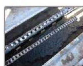
Retirada de gordura Remoción de las grasas
