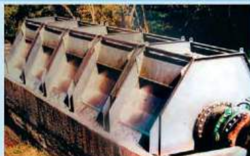
Operando em Captação de Água Operando en Captación de Agua
